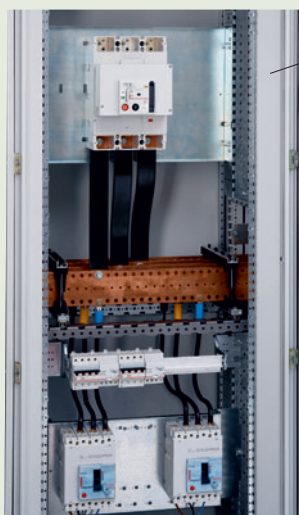
Montagem de um DPX 1600 A e de 2 DPX 250 A (vista interior do painel sem os espelhos frontais)
