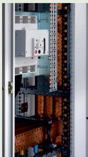
Montagem de um DPX 1600 A (vista interior do painel sem os espelhos frontais)
